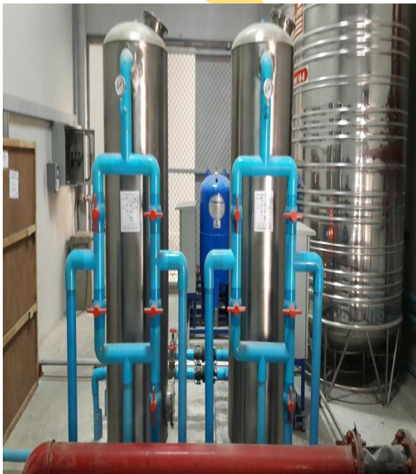
ตรวจสอบระบบกรองน้ำบาดาล
