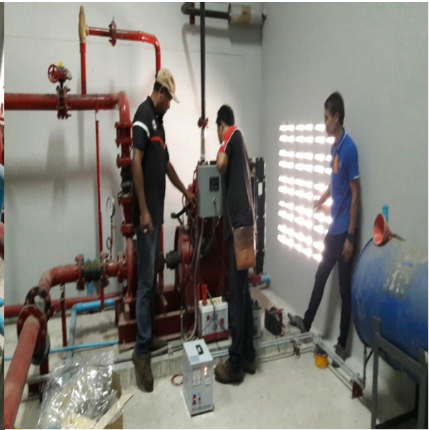
ตรวจสอบ Fire Pump
