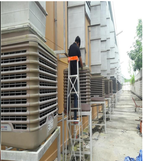
ตรวจสอบระบบลมเย็นไอน้ำ
