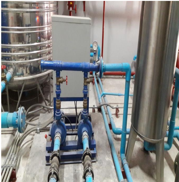
ตรวจสอบระบบ Water Supply Pump
